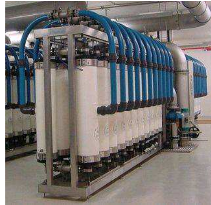
Bloc ultrafiltration usine de Lutry (CH) Mise en production en 2000
